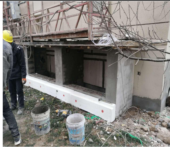
图 8 废气地面排口
