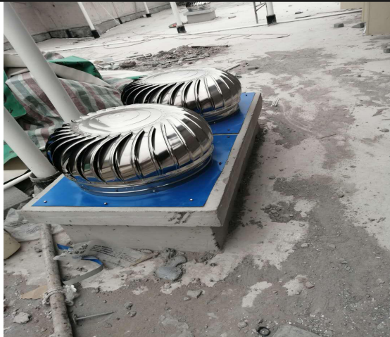
图 7 油烟专用管道楼顶的排烟口
