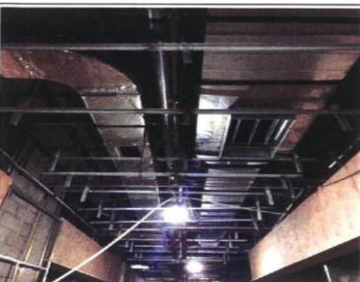
地下车库通风口
