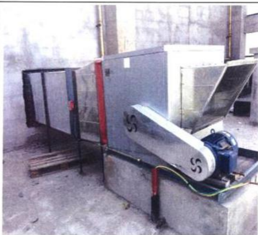
楼顶油烟出口
