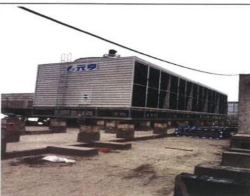
支座及冷却塔
