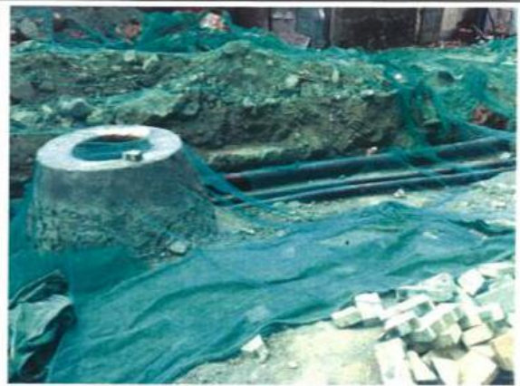
中水管道接口
