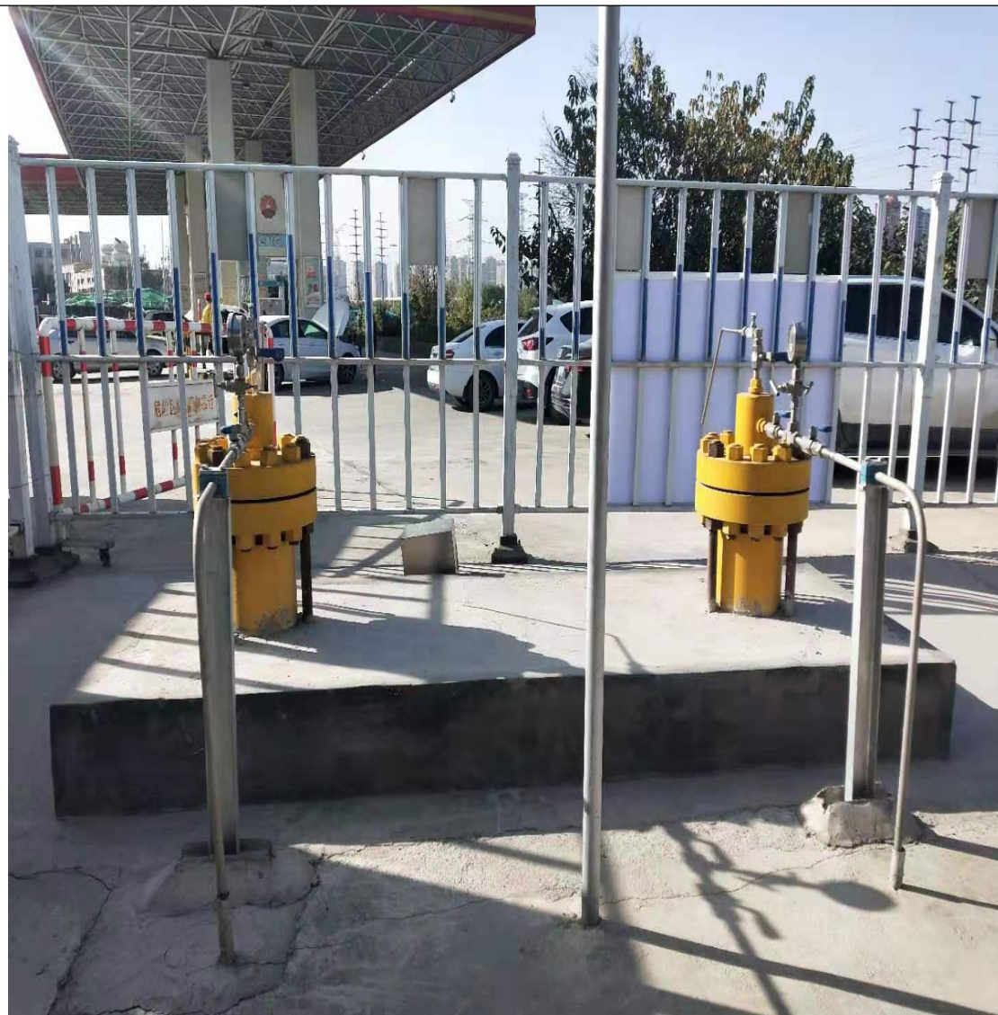
储油防渗设施
