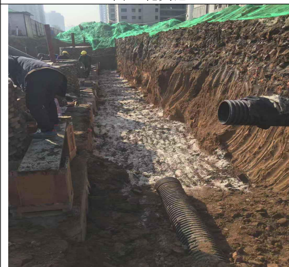
图 3 化粪池污水接口
