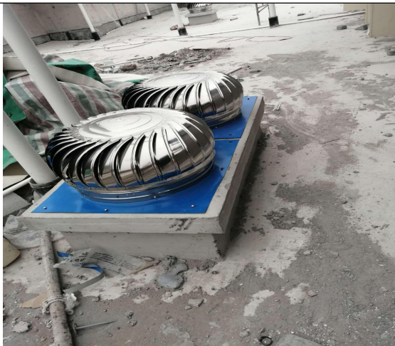
图 7 油烟专用管道楼顶的排烟口
