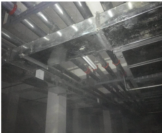
图 5 地下车库配套通风换气系统
