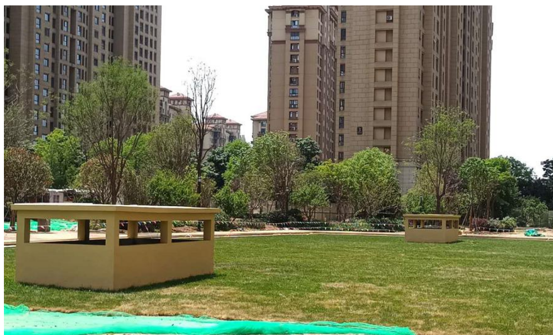
地下车库排气口
