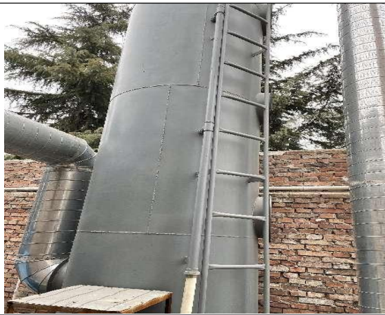
热处理喷淋塔
