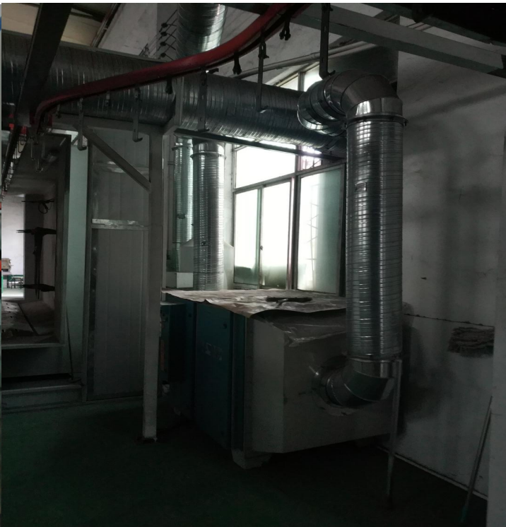
有机废气治理装置
