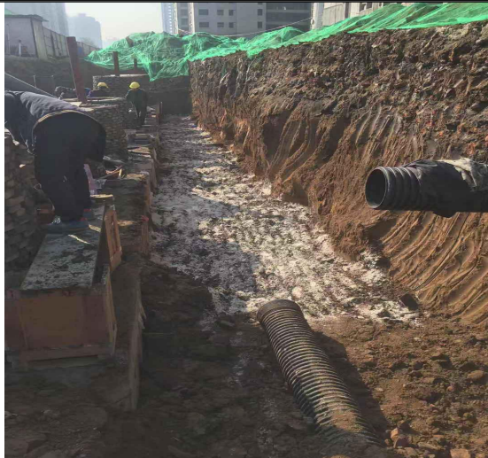
图 3 化粪池污水接口
