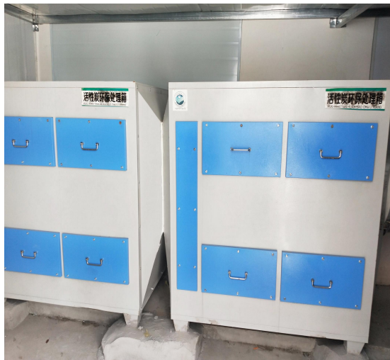
过滤棉+二级活性炭吸附装置+排气筒
