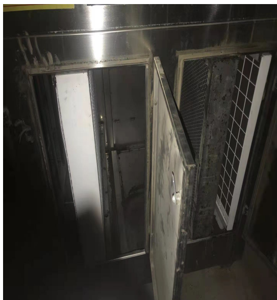
(1) 过滤棉+二级活性炭吸附装置
