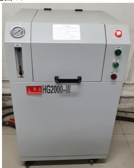
图 5 生产废水处理设施图
